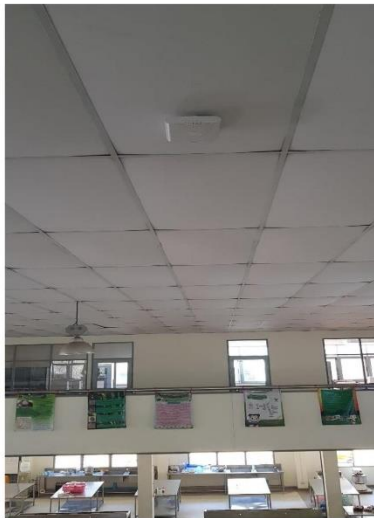
Name : AP – 04 Install : อาคาร UBI Floor : 1
