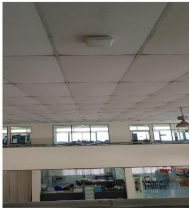
Name : AP – 05 Install : อาคาร UBI Floor : 1
